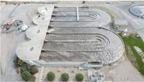
Oxidation Ditch (OD)
